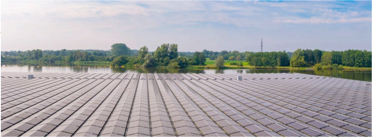
Drijvend Zonnepark Bomhofspas bij Zwolle. Er zijn lichtstraten tussen de panelen en de panelen zelf laten ook licht door. Onder de panelen zijn biohutten aangebracht, en de panelen zijn aan de bodem verankeren om de natuur aan de oevers te sparen. (Foto: August Swietkowiak in opdracht van de Dekker Groep)
